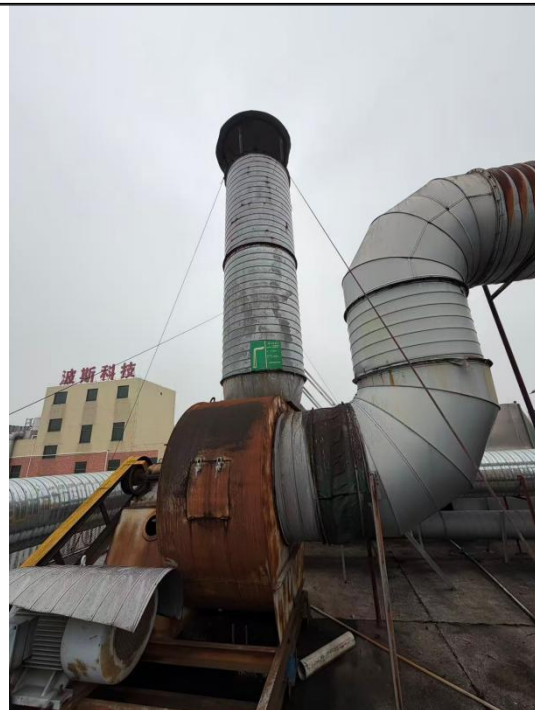
废气排放口（DA001）
