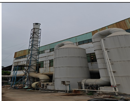
DA001 污水处理站——生物喷淋塔
