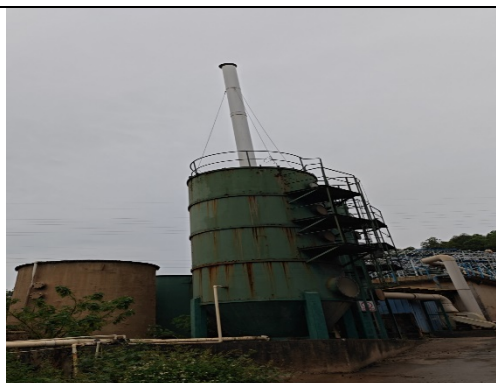
DA002 一般固废填埋场开泥场——高压喷雾 生物除臭抑尘+生物喷淋塔
