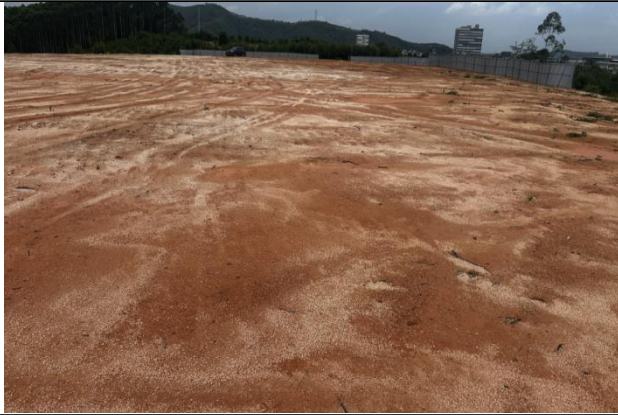
储能电站项目现状图
