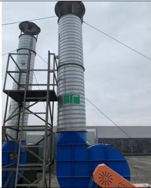
废气排放口 (DA001)
