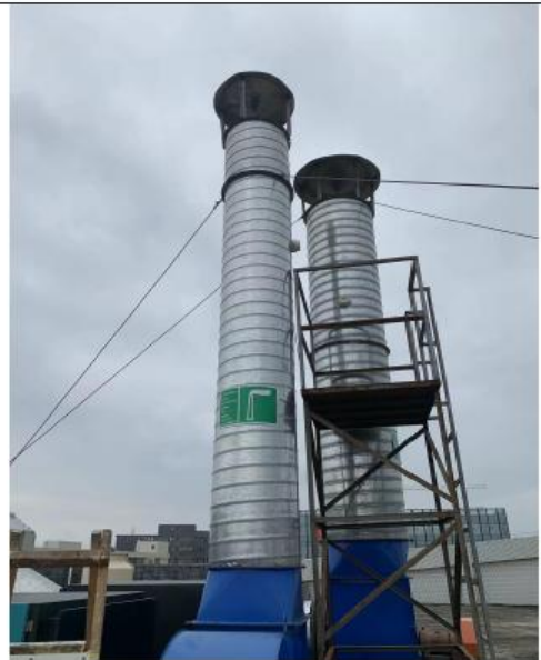
废气排放口 (DA002)
