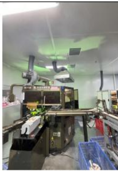
6楼印刷工序废气收集
