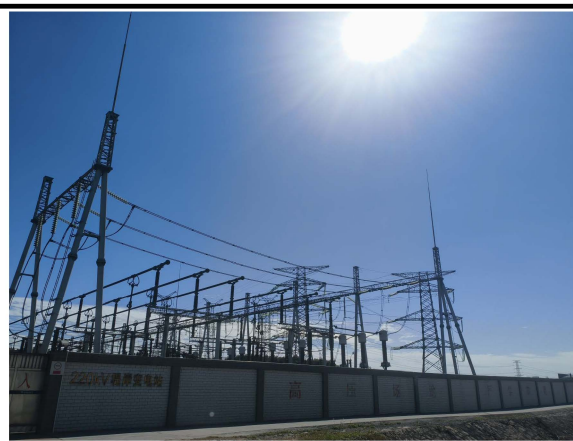
项目东南面（220kV 堤岸变电站）
