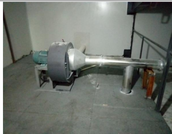
P3 排气筒风机
