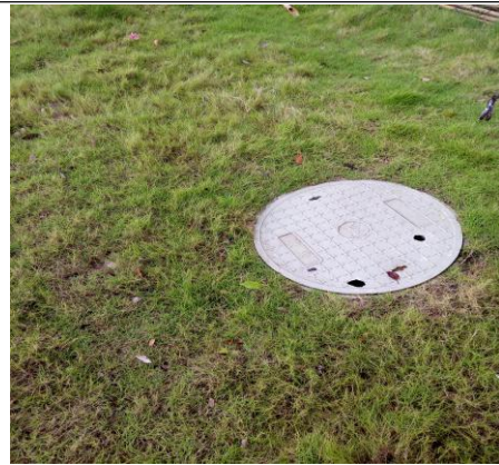
图片 2 厂区雨水接驳口
