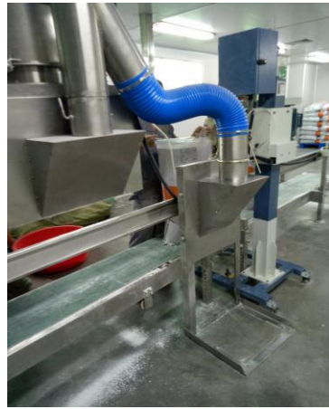
接料包装工序收集管道
