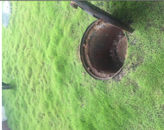
图片 1 三级化粪池（埋地）
