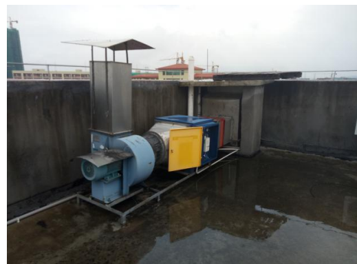
高效油烟净化器及 P2 排气筒
