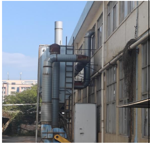
排气筒 DA002 及布袋除尘器
