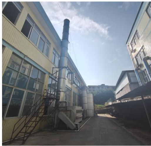
排气筒 DA001 及“喷淋塔+二级活性炭”装置
