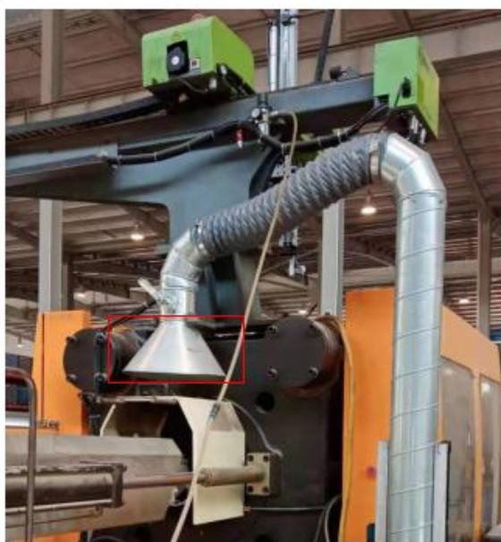
图片1注塑废气收集装置
