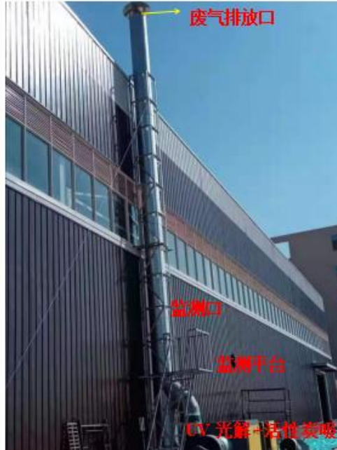
图片4 废气处理后监测平台与监测口
